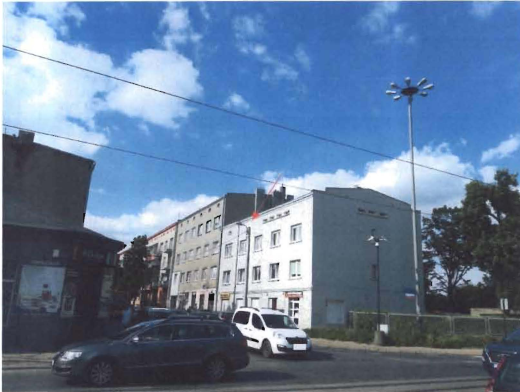
Zdj.1 Widok ul. Przędzalnianej z skrzyżowania z ulicą Przybyszewskiego – pierwsza latarnia, rozpoczęcie napowietrznej instalacji energetycznej zasilającej kolejne latarnie. ( łącznie 13 latarni )
