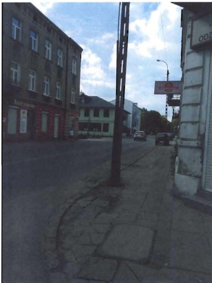
Zdj.7 Widok kolejnej betonowej latarni oraz widok studni kablowej znajdującej się w bliskiej odległości od słupa ( 6 z 13 latarni )
