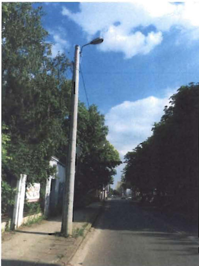
Zdj.16 Widok ostatniej latarni zlokalizowanej przy skrzyżowaniu ulicy Przędzalnianej i ulicy Milionowej oraz zakończenie napowietrznej sieci energetycznej zasilającej
