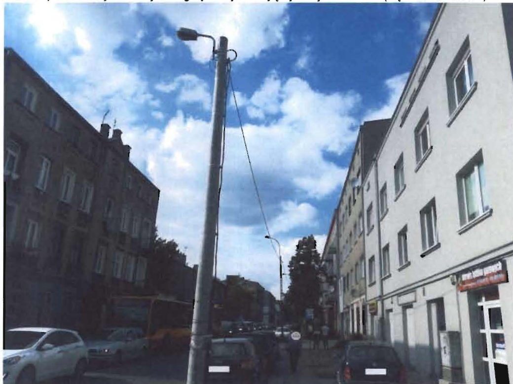
Zdj.2 Widok napowietrznej siedzi energetycznej zasilającej latarnie, biegnącej od pierwszej latarni zlokalizowanej przy skrzyżowaniu ulicy Przędzalnianej oraz ulicy Przybyszewskiego
